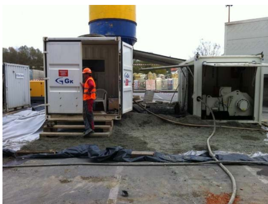
Postrojenje za mlazno injektiranje
