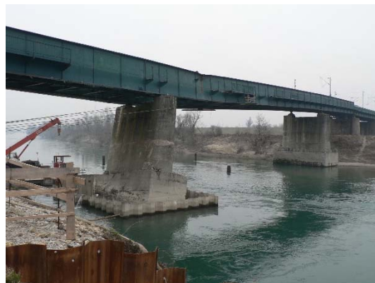
Slom tla ispod središnjeg stupa mosta
