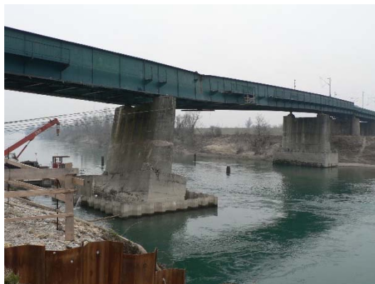
Grundbruch unter Brückenpfeiler
