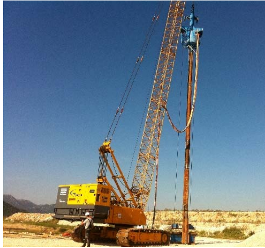
Gerät in Einsatz
