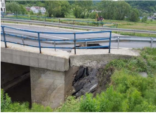
Unterkolung des Brückenwiderlagers
