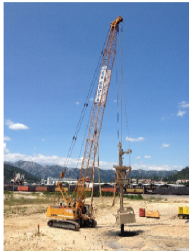
Gerät in Betrieb
